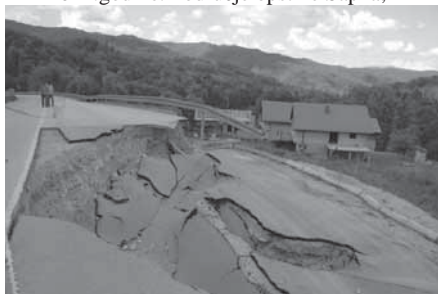
Slika 3. Oštećena putna infrastruktura tokom maja 2014.godine. Područje opštine Sapna, BiH
