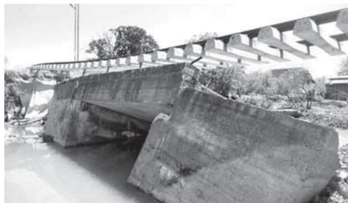
Slika 4. Oštećena dionica pruge. Srbija tokom maja 2014.godine
