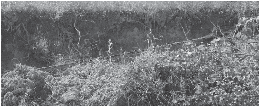
Slika 6: Oštećenje optičkog kabla izazvano pojavom klizišta
