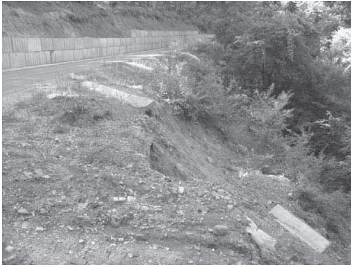
Slika 10. Primjer loše riješenog prikupljanja oborinskih voda – Majejica (foto: T. Nikolić, juni 2010.)
