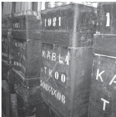
Slika 10: Završni nastavci kablova sa olovnim plaštom i papirnom izolacijom
