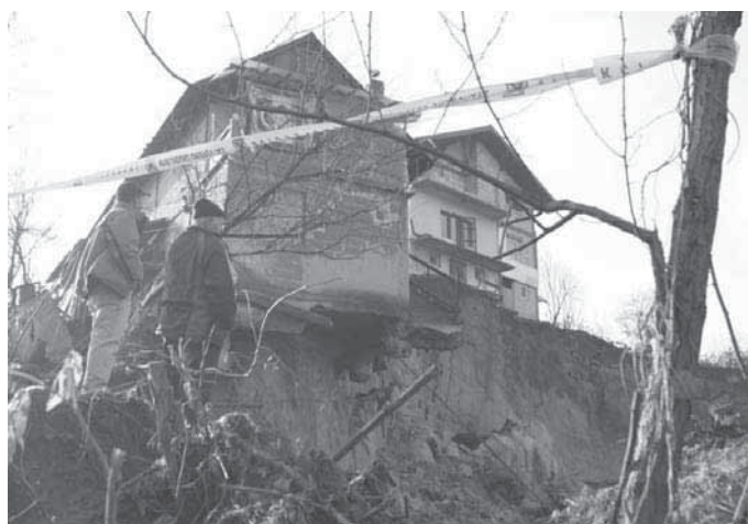
Slika 4 – Klizište posljedica divlje gradnje u Crvenim Njivama u Tuzli 2010.godine kada su smrtno stradale tri osobe
